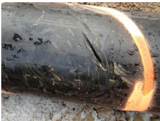
Рисунок 44 – Дефекты внешнего слоя без нарушения армирования
