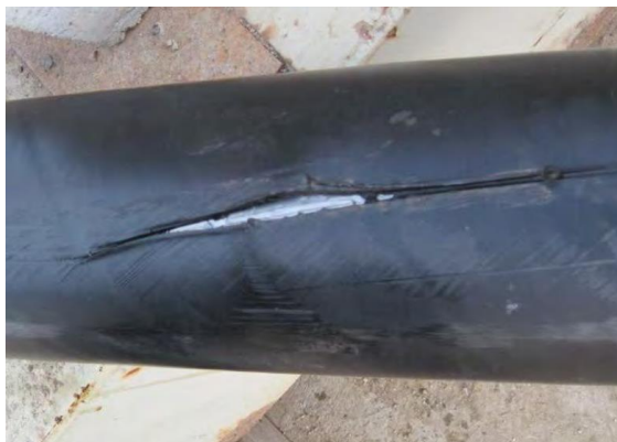
Рисунок 45 – Дефекты внешнего слоя без нарушения армирования
